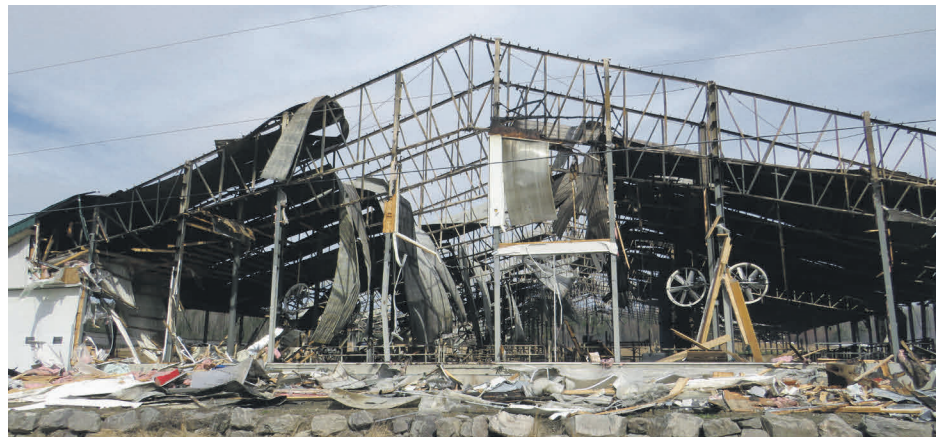
Le bâtiment de ferme, au lendemain de l'incendie. Photo Véronique Bossé
