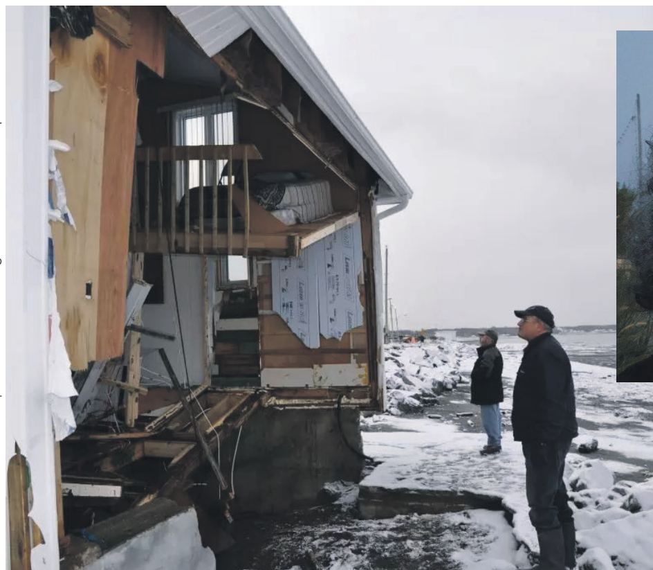
Une photo des dommages à Sainte-Flavie. Photo archives Sonia Lévesque
