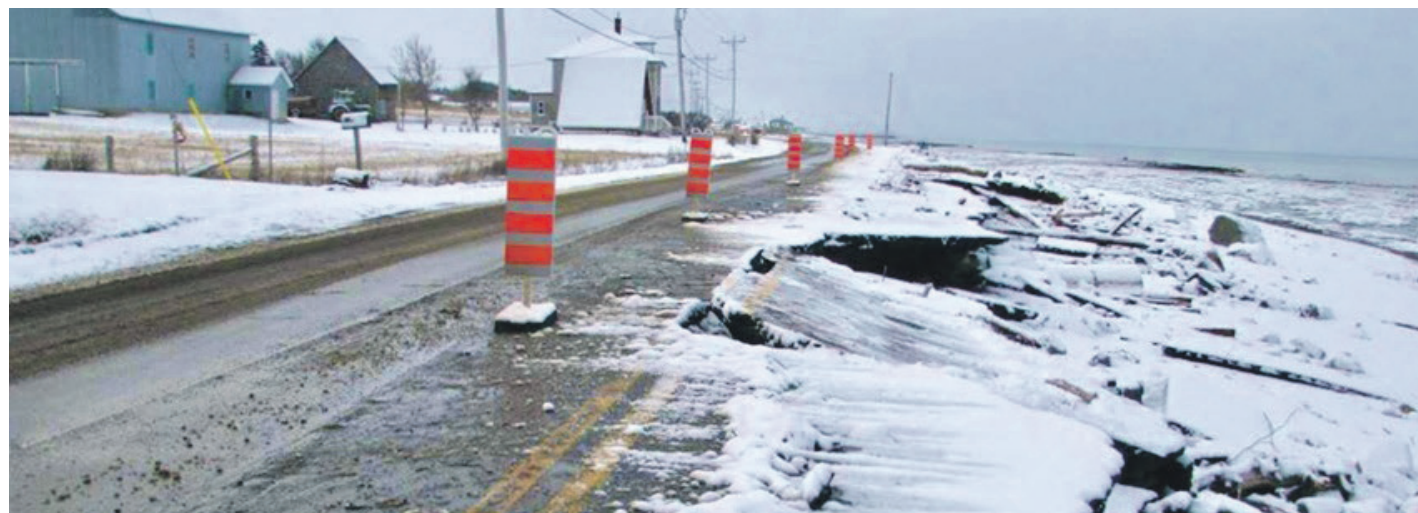
La route 132 avait été lourdement endommagée en plusieurs endroits. Photo courtoisie
