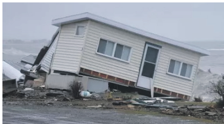
Les dégâts ont été considérables lors des grandes marées de 2010 Photo archives Le Soir
